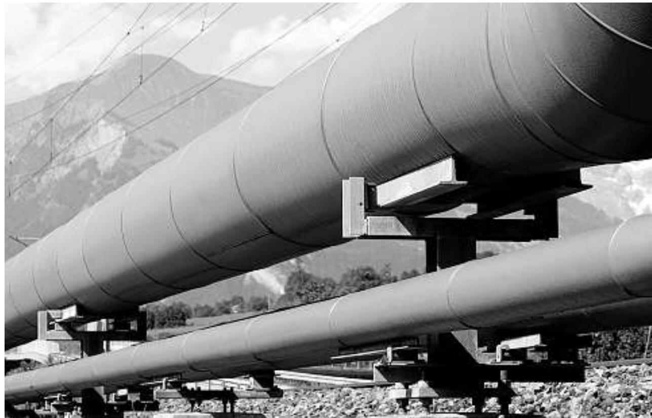
Weiterer «Energiestrang» geplant: Ungefähr so wie die bestehende Prozessdampfleitung zwischen der KVA Trimmis und der Papierfabrik Landquart wird auch die Fernwärmeleitung aussehen, die nach Chur Nord verlegt wird. Bild Jakob Menoffi
